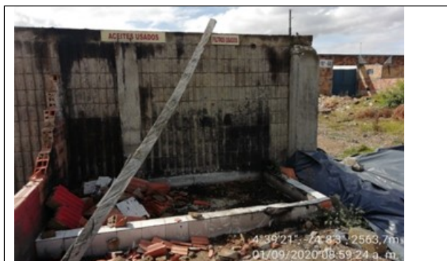
Fotografía 8. Estructura con manchas de aceite usado
